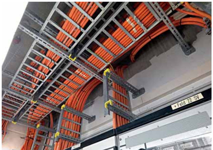
Funktionserhalt-System in der Energiezentrale
